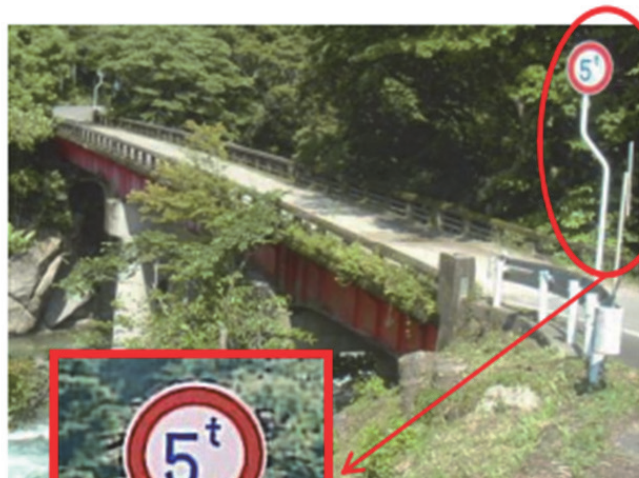
図表 I-1-1-43 老朽化による通行規制の状況
