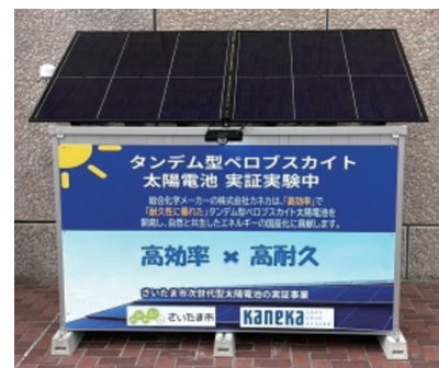
図表 I-2-1-34 タンデム型ペロブスカイト太陽電池の公共施設での屋外実証
