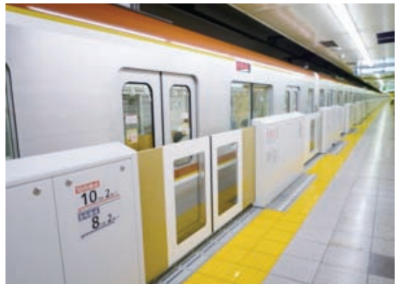
図表2-6-8 ホームドアの設置状況
