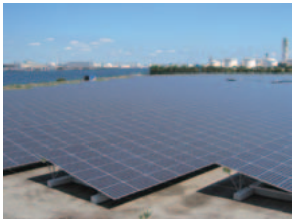
図表 2-6-26 扇島太陽光発電所
