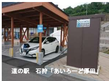
【道の駅でのEV充電状況】
