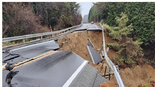
図13 能登半島地震における大規模崩壊(能登自動車道) (出典:国土交通省「令和7年度 道路関係予算概要」)
