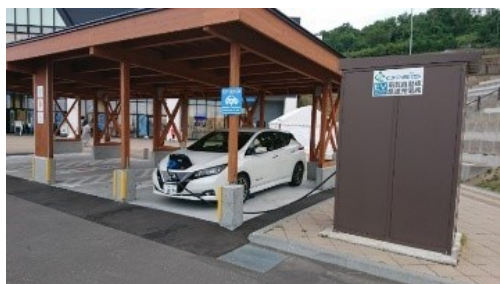
道の駅におけるEV充電器の設置例（石狩市）
