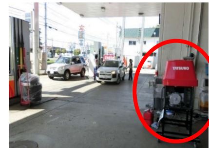
停電直後から、自家発電機を稼働させて給油を続けた中核SS （北海道札幌市／2018.9.6撮影）
