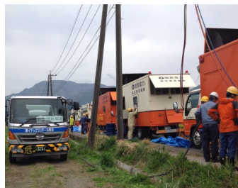
停電地域において「移動電源車」に タンクローリーから軽油を供給 （熊本県阿蘇市／2016.4.18撮影）
