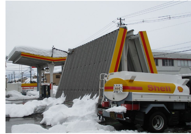
雪の重みでキャノピーが真っ二つに折れ、一時営業停止に追い込まれたＳＳ（1月12日富山市内）
