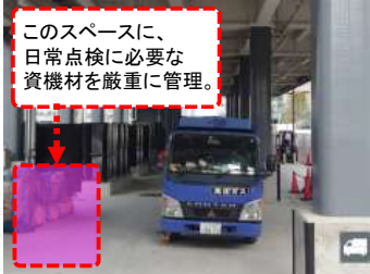
(日常点検の予定場所)
