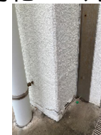
外壁のひび割れ
