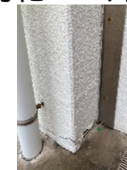
外壁のひび割れ
