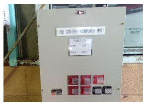
ラインコントロールコンピューターユニット
