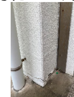
外壁のひび割れ
