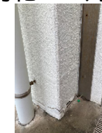
外壁のひび割れ
