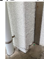
外壁のひび割れ
