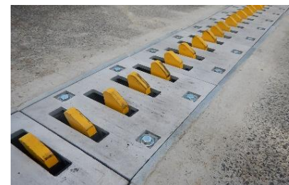
物理的対策 （路面埋込型ブレード）
