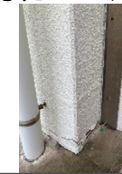
外壁のひび割れ
