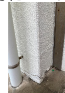
外壁のひび割れ
