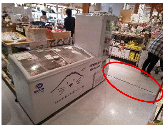
【道の駅 冷凍ショーケースへの給電】
