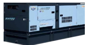
非常用電源設備
