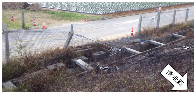
図3 損壊したフェンス
