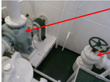
バラストポンプ
