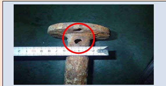
写真2 海水取入れ配管の破口
