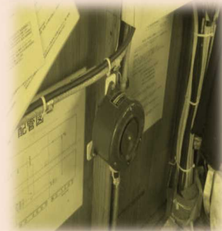
延長警報装置（船橋）
