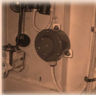
延長警報装置（機関室）
