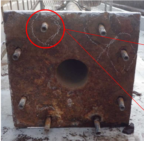
倒壊した信号機の台座(下面)
