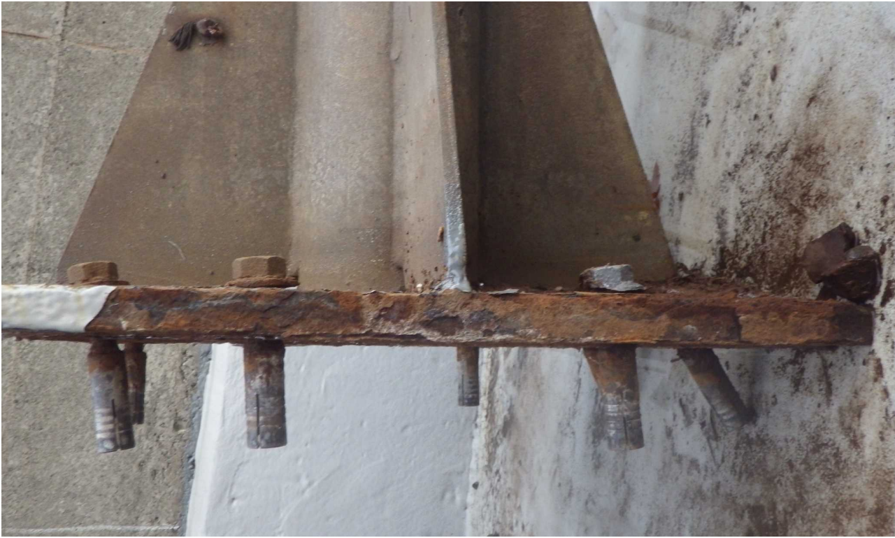
倒壊した信号機の台座(横)
