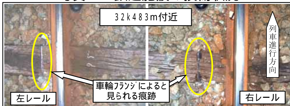
写真3 鉄道施設の損傷状況
