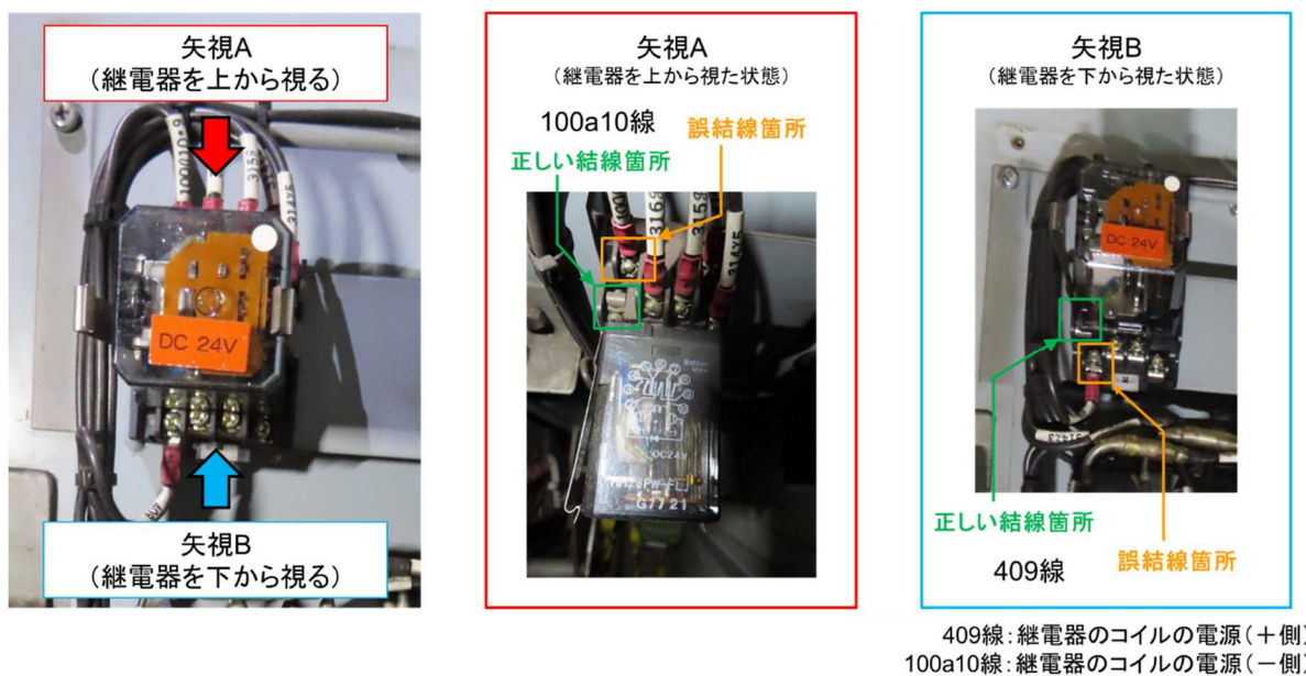
図3 速度検出補助継電器のぎ装配線の結線状態
