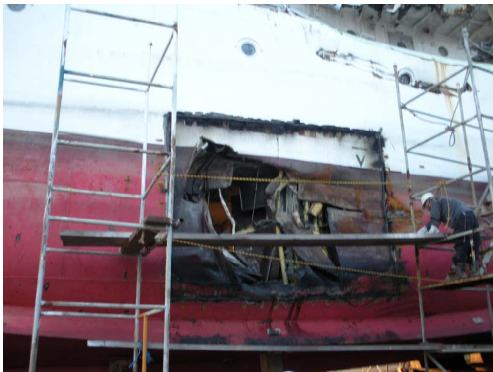
写真4 B船機関監視室損傷状況
