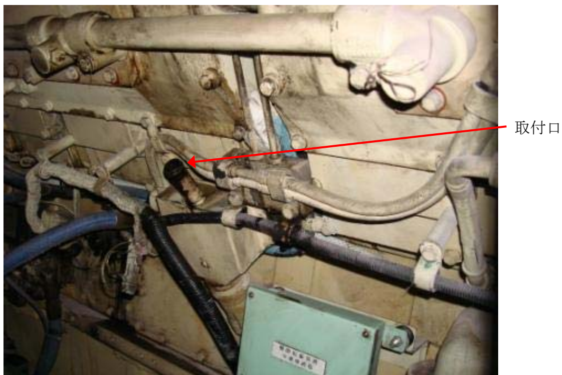
写真4 右舷主機の左側ミスト管取付口
