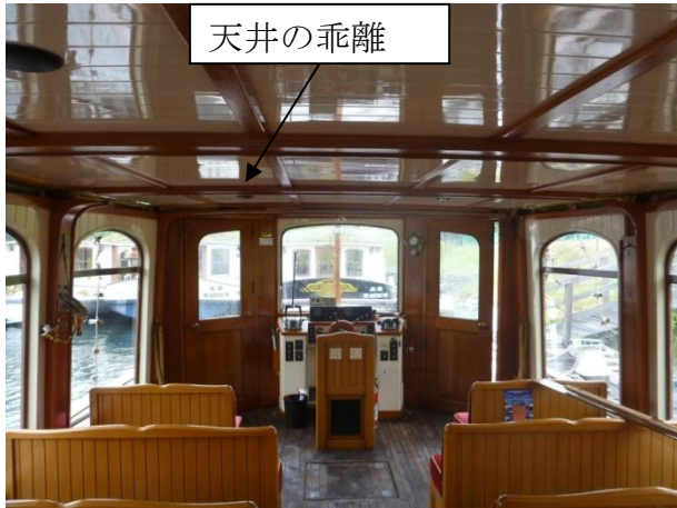
写真4 客室船首方の損傷
