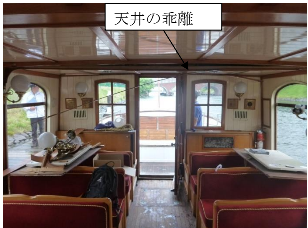
写真7 客室船尾方の損傷
