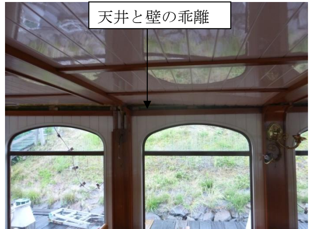
写真5 客室左舷側の損傷
