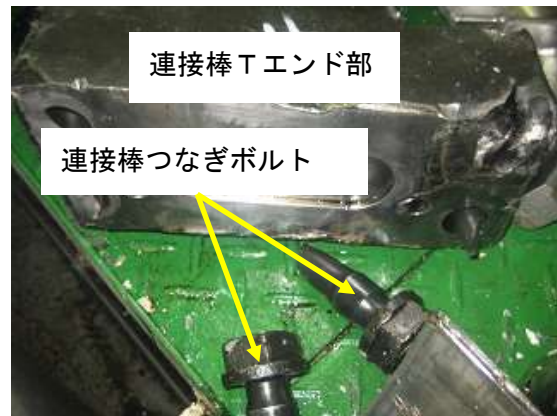
写真8 6番シリンダ接続棒つなぎボルトの折損状況2
