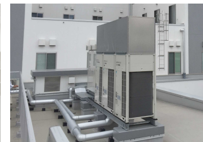
設備機器のメンテナンス
