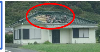
強風による屋根の被害(南房総市)
