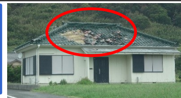
強風による屋根の被害(南房総市)
