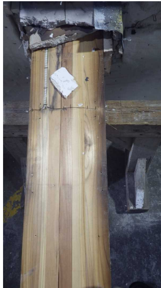
120-No.6 接合部の 割れ
