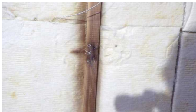
90-No.1の状況 左：試験後 右：野縁の変色
