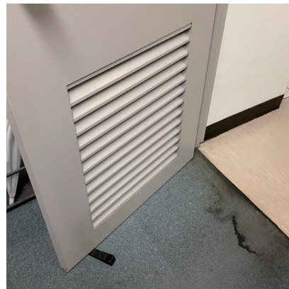
くさびにより解放状態に固定されている防火扉
