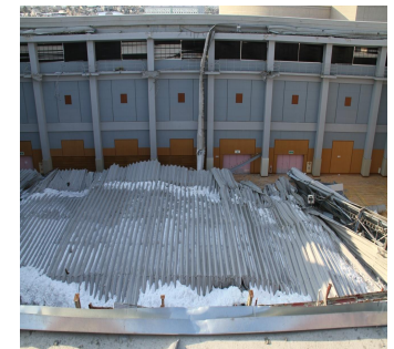
体育館の屋根崩落被害(埼玉県)
