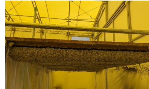
A-4 (表面処理なし、脱落防止措置天井インサート) の剥離の様子
