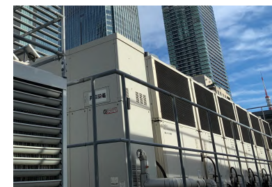
屋上の省エネ設備
