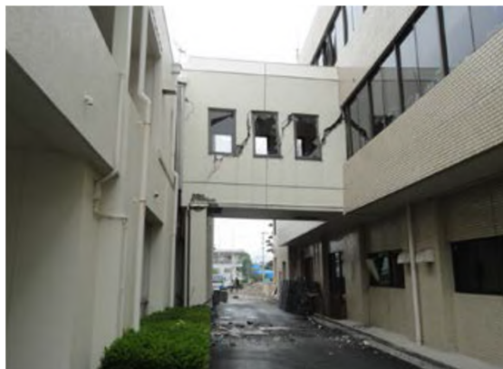
庁舎における構造部材の損傷
