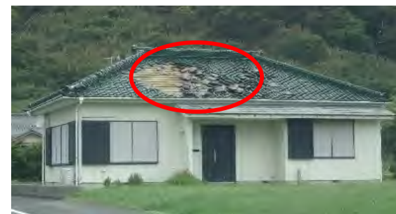
強風による屋根の被害(南房総市)
