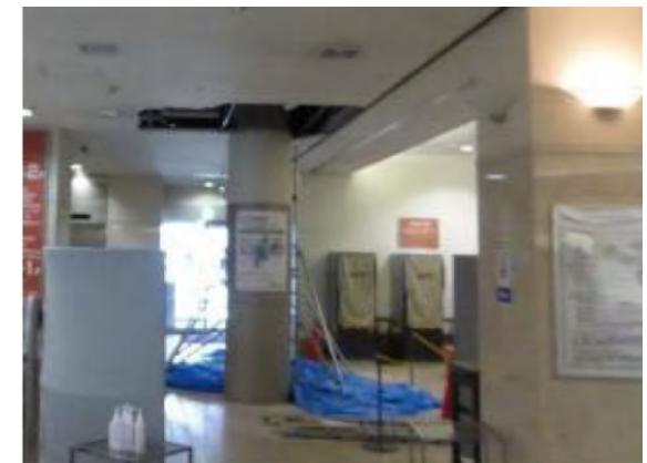
病院における天井の損傷
