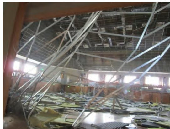
体育館における天井の損傷
