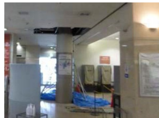
病院における天井の損傷
