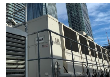
屋上の省エネ設備
