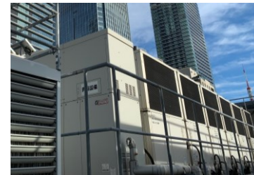
屋上の省エネ設備
