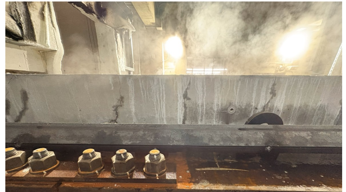
スラブのひび割れ
