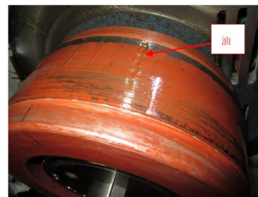
写真2 モーターローター 油付着状況
