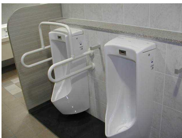
I 手すりの設置された男性用小便器
