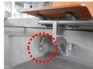
集団補聴設備の設置
