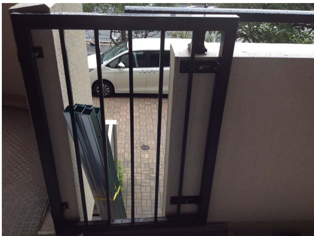
EXP連動手すり 稼働できるようにルーズとなっている。
