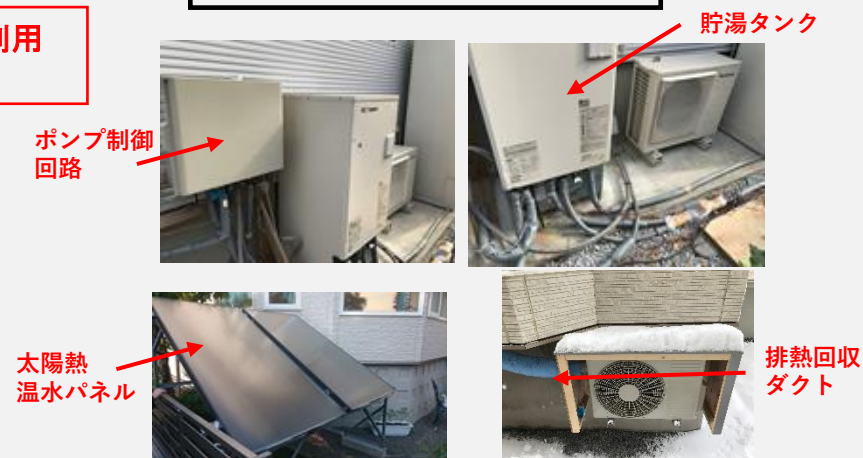
実証住宅設備設置状況
