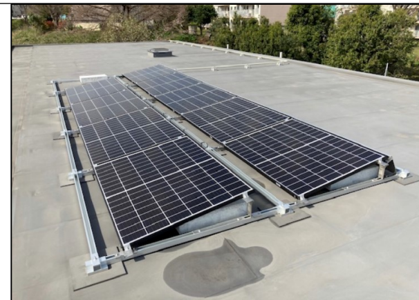
【屋上に設置した太陽光パネル】
