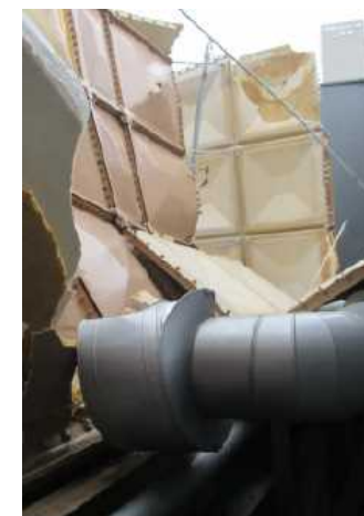
被災状況②
