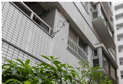
被災状況②
