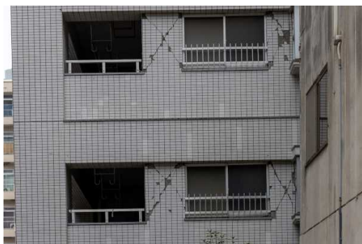
被災状況①
