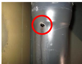
排水管劣化状況
