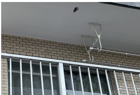
バルコニー上げ裏のコンクリート剥離
