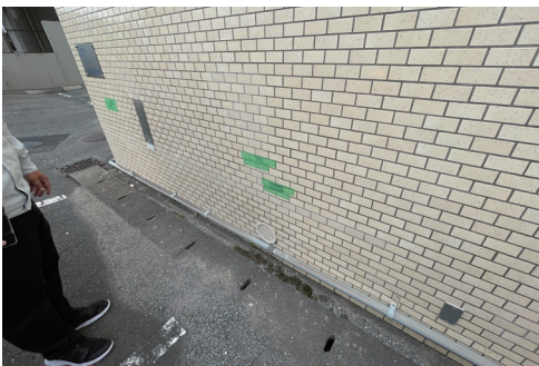
外壁タイル剥離
