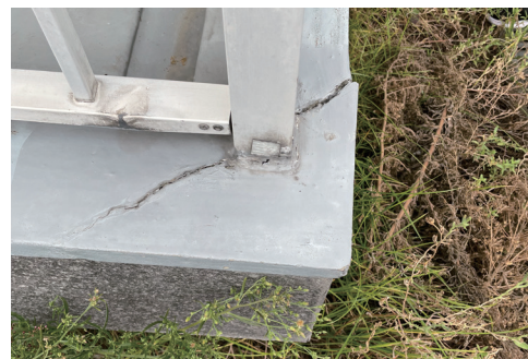
バルコニー手すり根本のひび割れ
