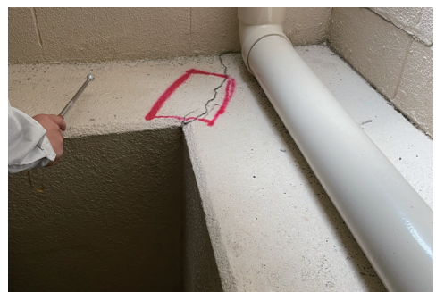
外壁のひび割れ
