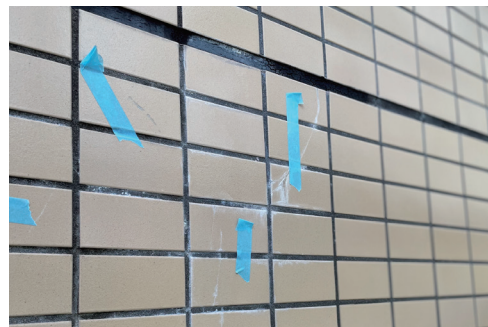
外壁タイルひび割れ箇所
