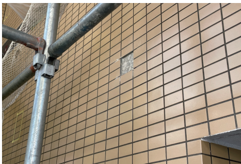
外壁タイル剥離
