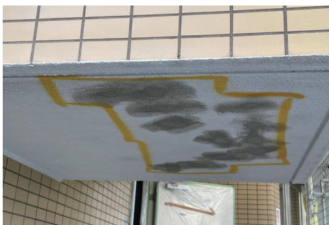
上げ裏の漏水箇所
