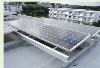
太陽光発電関連設備の設置
