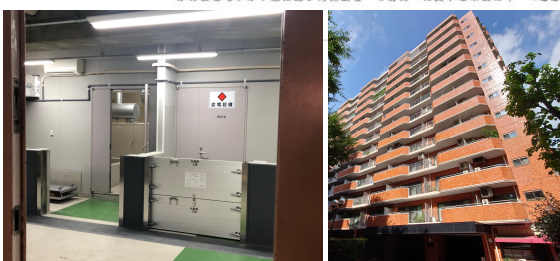
設備室内止水板
